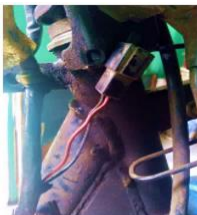
Gambar 10. Jalur kabel stop kontak
