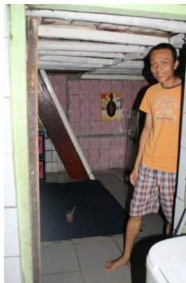
Gambar 5. Rumah di RT 8, 2 lantai dengan struktur dan material yang rawan kebakaran.
