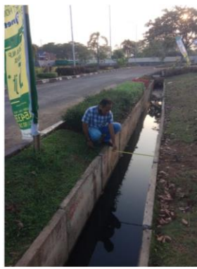
Gambar 04 Saluran U-Ditch Sekunder
